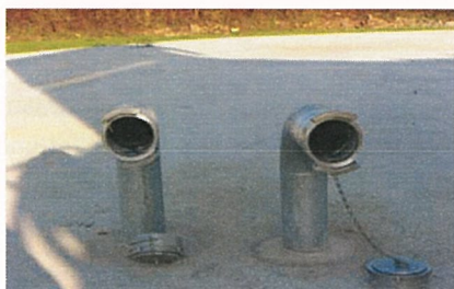
Deux colonnes d'aspiration de 100 mm sur une réserve d'eau enterrée
