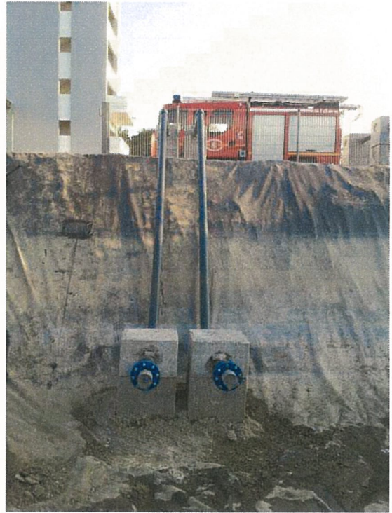
Deux colonnes de 100 mm sur une réserve d'eau
