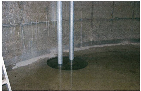
Fond de la cuve avec crépine sous le niveau le plus bas de l'eau
