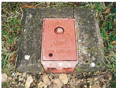
Bouche de lavage fermée
